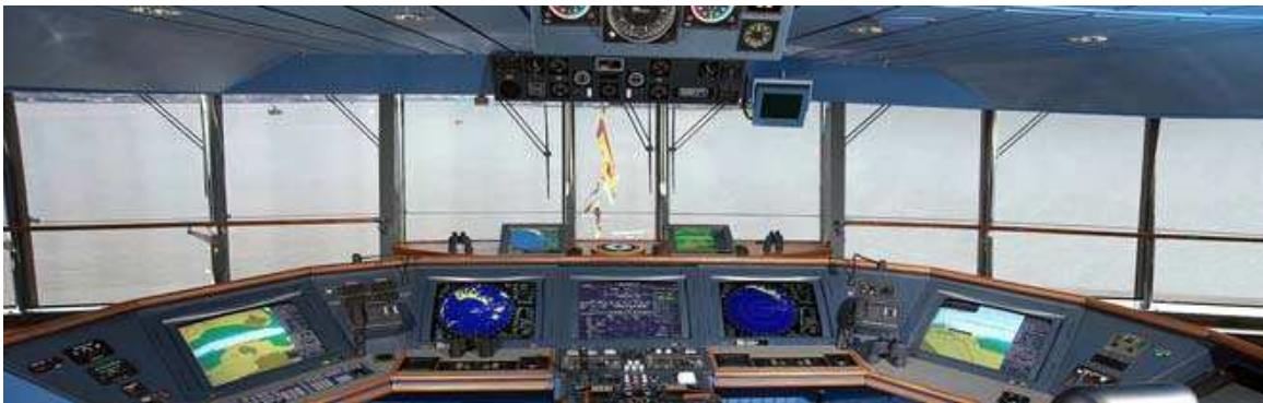
Figura nº7.- Integración de equipos, sensores en un puente de gobierno.
